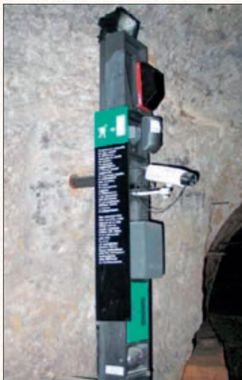
Obr. 9. Řadu technických zařízení lze sdružit do jednoho místa a tak zajistit, aby co nejméně rušilo památkovou instalaci. V tomto případě je sdruženo osvětlení, systémy PZTS, EPS a CCTV, monitoring mikroklimatu a značení únikové cesty.
