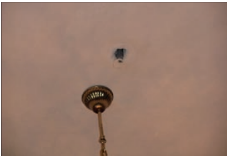
Obr. 41. Poškození interiéru vinou kondenzace vodních par v potrubí nasávacího systému
