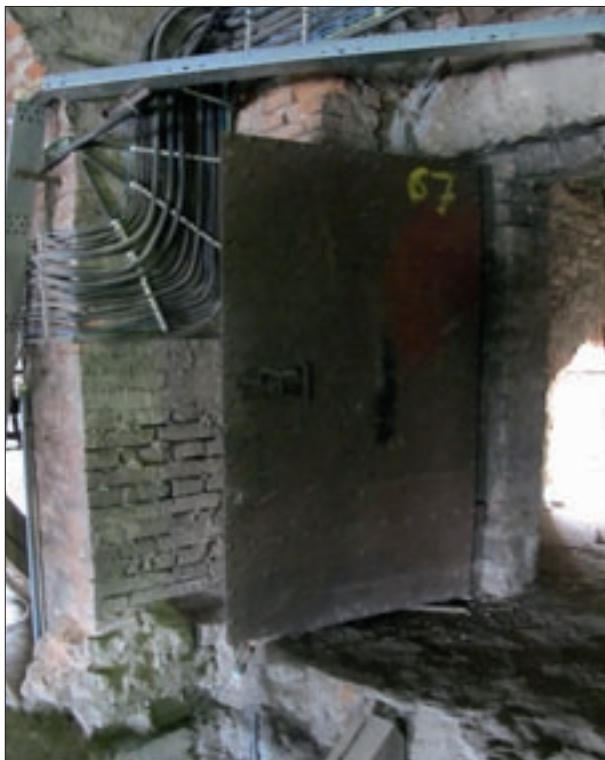
Obr. 66. Ocelové dveře (většinou zkorodované)
