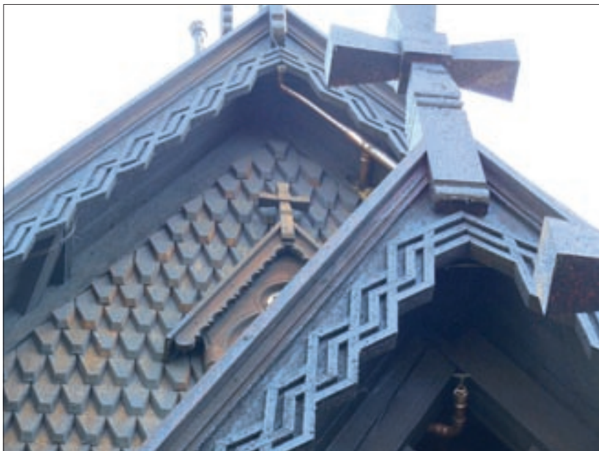
Obr. 49. Venkovní sprinklerové vedení ve sloupovém kostele v Urnesu, Norsko
