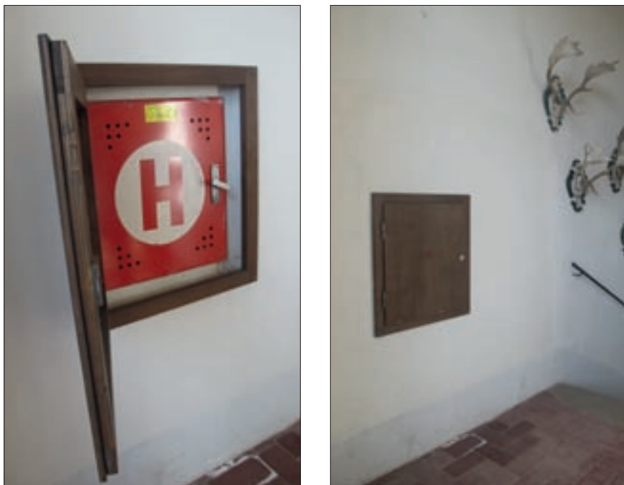
Obr. 12. Nástěnný hydrant v památkovém objektu – zámek Jindřichův Hradec
