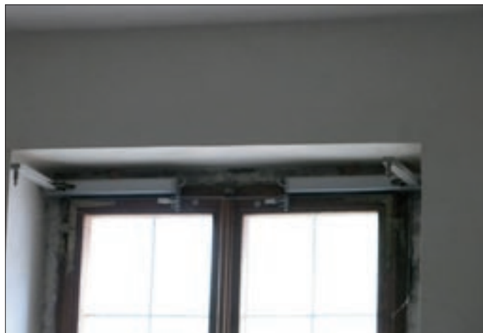
Obr. 75. Odoětrání únikové cesty samočinným oöládáním otevöírání okna – hospital Kuks
