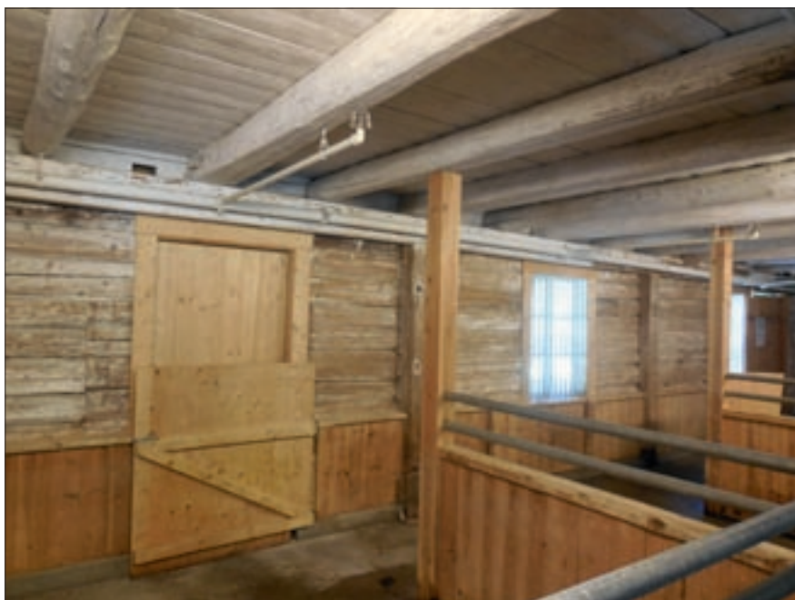
Obr. 48. Sprinklerový rozvod a hlavice ve Folkemuseu v Oslo, Norsko
