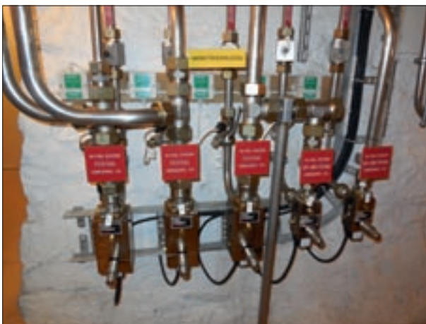
Obr. 53. Rozvody vysokotlaké vody do jednotlivých sekcí v univerzitní aule v Oslo
