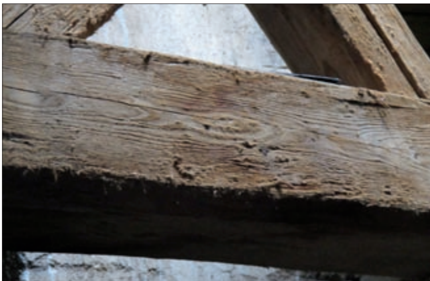
Obr. 70. Protipožární nátěry na hradě a zámku Frýdlant na půdě budovy zámku – rozvláknění dřeva je zde patrné na celé konstrukci krovu
