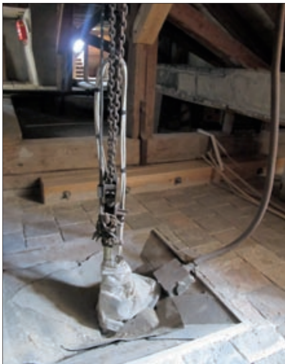
Obr. 63. zámeček Lednice – masivní lustr ukotven skrz podlahu v půdních prostorách
